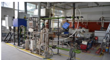
Centrala termica clasica cu turbina de abur, centrala in cogenerare cu motoare diesel si Otto, centrala termica de apartament
